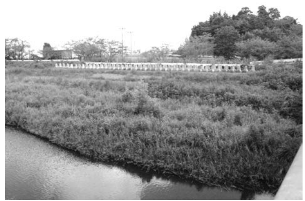
堤防が決壊した所。テトラポットで仮復旧
