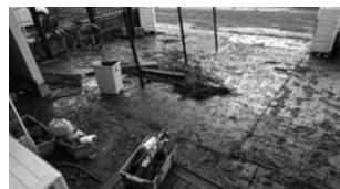
水が引いた後の被災状況 （家の前）
