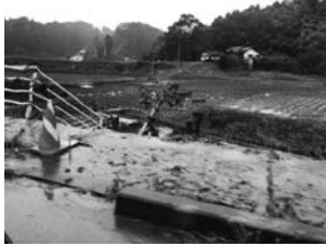
角田市：道路ののり面が崩落
