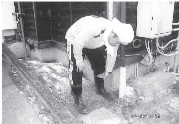
【台風後、床下浸水の状況】
