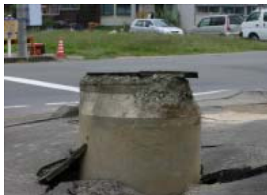
1メートルも出てきたマンホール
