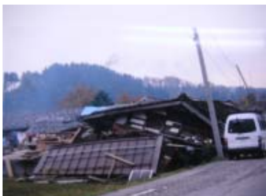
無惨な全壊状況(小千谷市)
